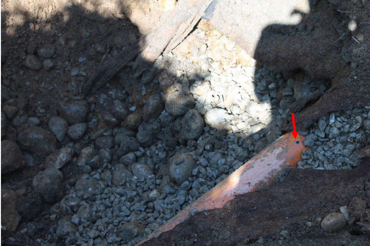
Bilde 5: Sprederør står fullt med avløpsvann, se rød pil. Utløpshull i bunn rør er tette.
