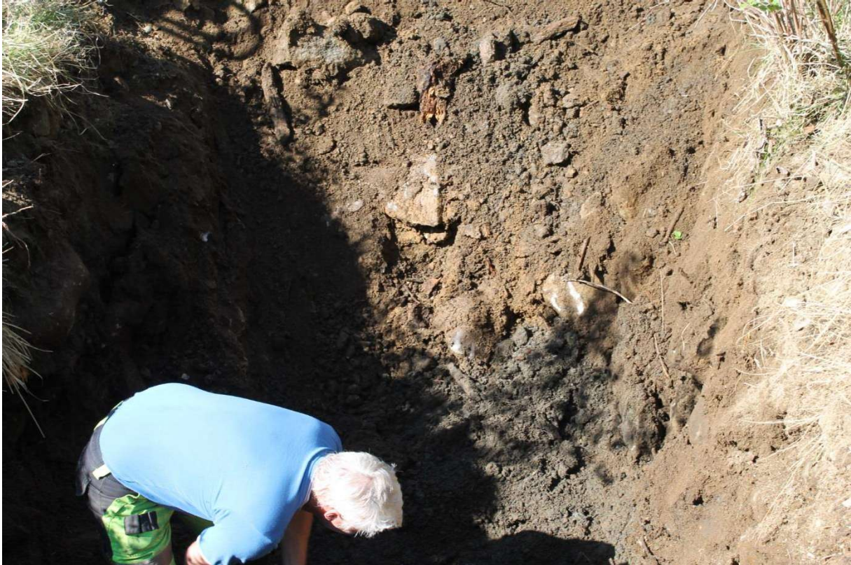
Bilde 7: Infiltrasjonsanlegget er lokalisert i siltige morenemasser med svært lav infiltrasjonskapasitet.
