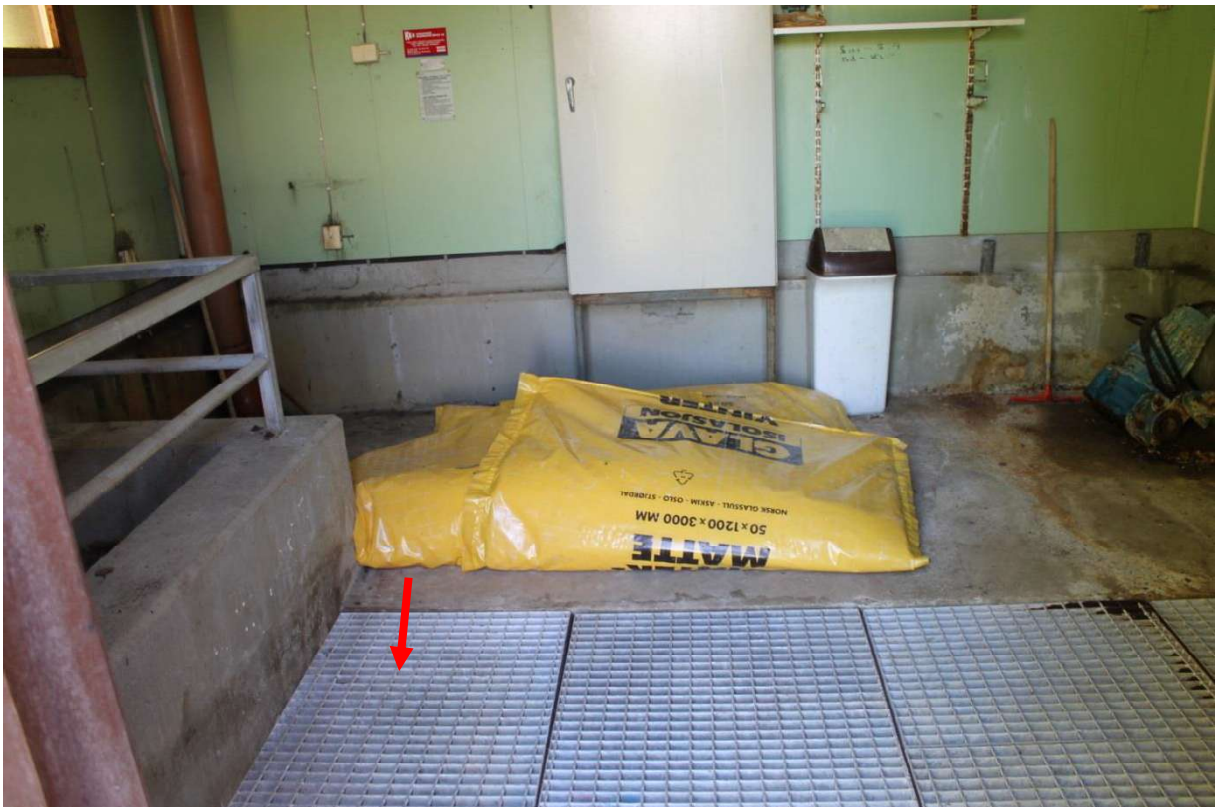
Bilde 2: Slamavskiller, andre kammer, i nordvestre del av bygg. Innløp vist med rød pil.
