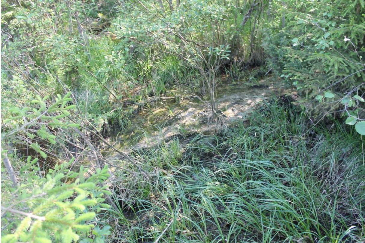
Bilde 9: Utslag av urensset avløpsvann nedenfor infiltrasjonsanlegget.
