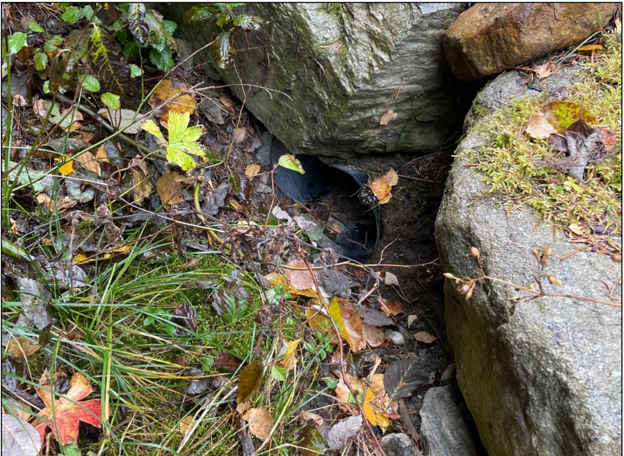
Figur 8: En stikkrenne på 250 mm under adkomstveg til Søre Gubberud.
